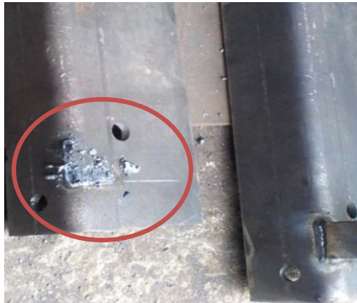
Gambar 2. Bentuk Kecacatan Pemasangan Kaki Siku Sumber : PT Karya Abadi Lestari
